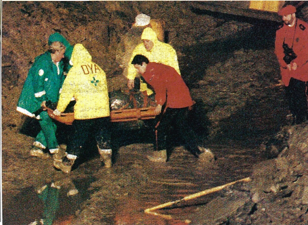
Imagen del accidente en las obras de Sondika.
