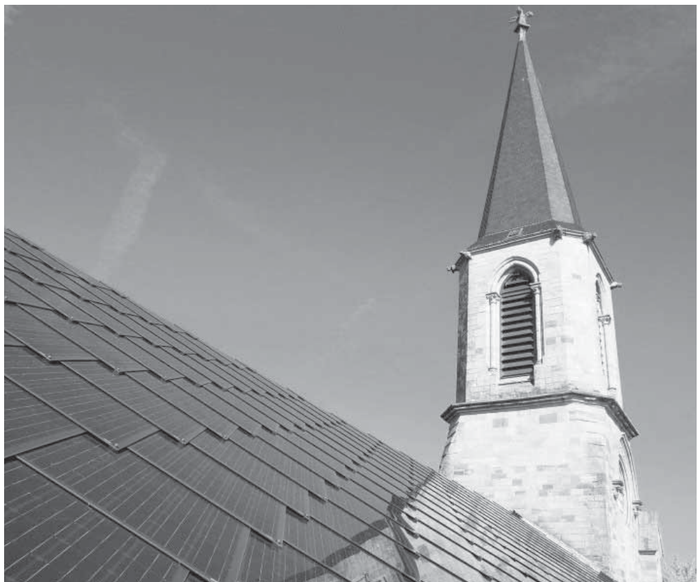
Panneaux solaires photovoltaïque installés sur la toiture d'une église.
