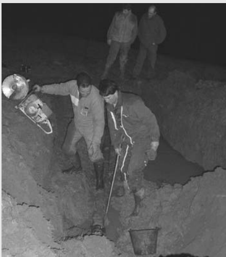
Intervention sur une fuite nocturne d'une canalisation d'eau potable de la commune
